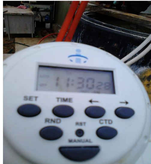
Figura 7: Instalación de taimer
